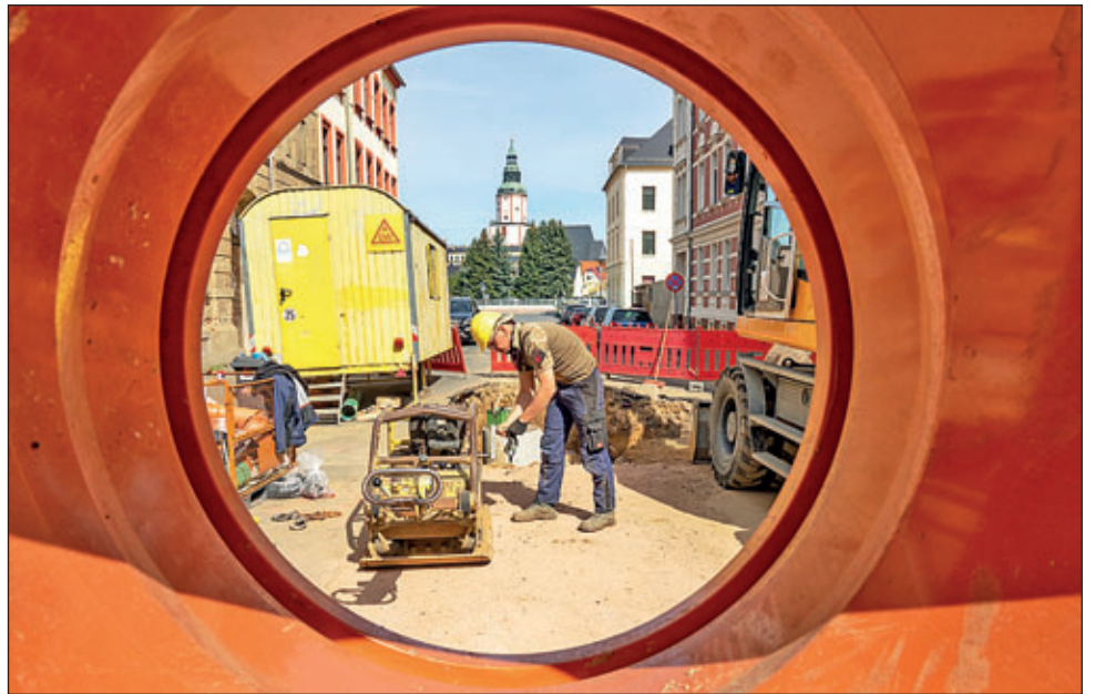
Rohr frei: In der Schillerstraße werden zur Zeit die Misch- und Abwasserleitungen erneuert (im Foto: Sascha Fiedler von der Firma ADW).
