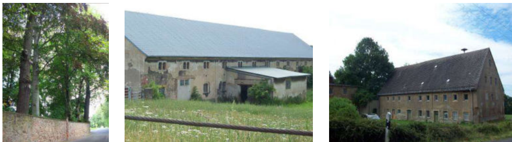
Abbildung 2.8-43: Sanierungsbedürftige Mauer und Gestütsgebäude, Leerstand in der Bergstraße
