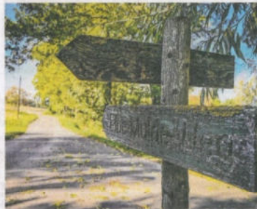
Der Elbe-Mulde-Weg führt durch den Döbener Ortsteil Schweinitz. Ab dieser Woche soll ein fast ein Kilometer langer Abschnitt in Richtung Auterwitz ausgebaut werden.
